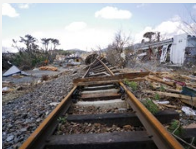
2011年3月25日、気仙沼市本吉町三島(大谷地区)の状況。JR気仙沼線、大谷海岸駅構内から仙台方面に伸びる線路。左手は大谷海岸になるが、引き波によって枕木ごと持ち上げられたレールがめくれあがり、螺旋を描いてしまっている。ジェットコースターの軌道ならば疑問は感じない。しかし、これはあくまで鉄道のレールである。本線の再開については全く見通しが立っていない。
